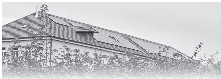
Sluneční elektrárna na školní jídelně
