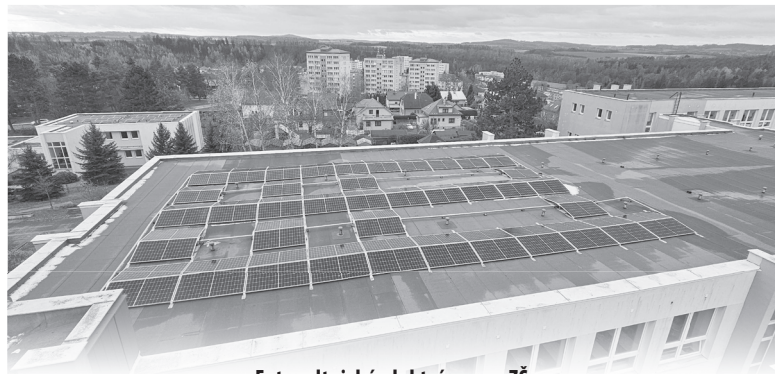
Fotovoltaická elektrárna na ZŠ
