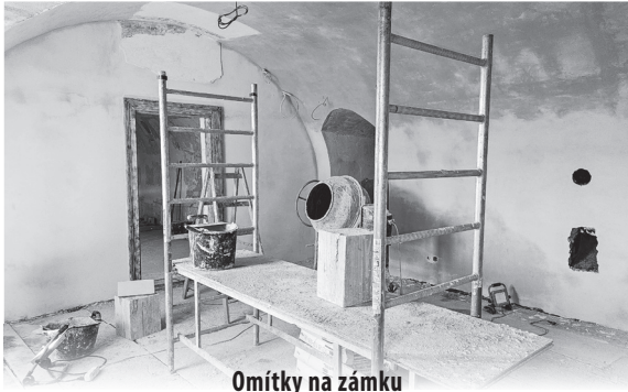
Omítky na zámku
