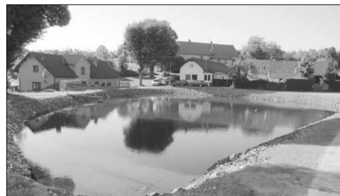
Rybník v Želivci prošel rekonstrukcí ... Cílem projektu bylo odbahnění a rekonstrukce bezpečnostního přelivu rybníka. Dále se opravil odtok pod hrází a došlo k opevnění návodních svahů rybníka. Zmíněné opatření vedou k zadržení příválových vod a zmírnění povodňové vlny v nižším povodí Želivského potoka. Dále jde o posílení stability vodního režimu a protierozní ochrany včetně obnovy vegetačních porostů. Odbahněna byla celá plocha rybníka – průměrná hloubka nánosů je 0,53m. Opevnění návodní strany bylo provedeno kamenným pohozením. Bezpečnostní přeliv tvoří kruhový propustek. Dílo bylo dokončeno v červenci 2013 v ceně 880 tis. korun. (foto Martin Hujer)
