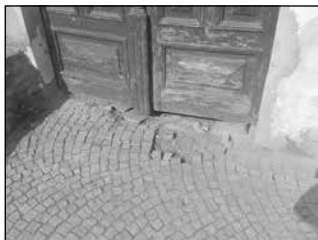
Poškozená dlažba ve Strmé ulici
