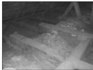
Trámy poškozené hnilobou
